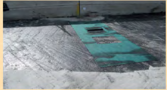
3 a fase: si nota il riquadro rimosso e lo strato di primer sottostante, praticamente integro (senza rimozione di cls.).
