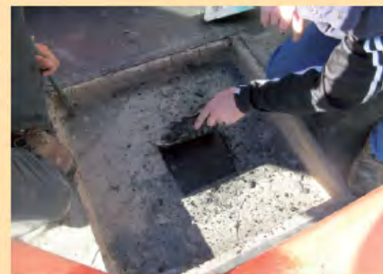
2ª fase: asportazione dello strato termoisolante, (perfettamente asciutto, in tutto il suo spessore) ed asportazione di un tassello di membrana, in bitume polimero, costituente lo strato "Schermo al Vapore": La superficie del massetto delle pendenze risulta perfettamente asciutta.
