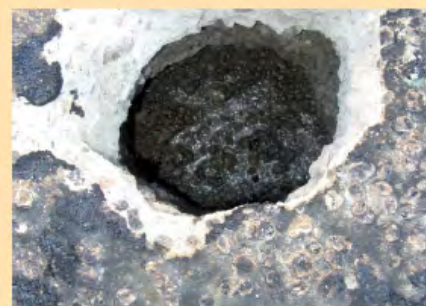
4ª fase: completamento della rimozione della cappa di Cls e messa a nudo dello strato di argilla espansa sciolta, sul fondo si nota una lama di alcuni mm di spessore di acqua.
