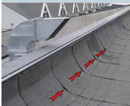
Risvolto verticale di membrana in bitume polimero, risvoltata direttamente dal piano sul verticale. La mancanza di una protezione e fissaggio meccanico sulla parte terminale, ha causato, per il calore estivo, lo scollamento della membrana dal supporto.
