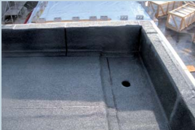
Risvolto verticale in membrana in bitume polimero, realizzato correttamente su copertura con supporto in lamiera grecata e con giunto perimetrale rispettato. Il particolare esecutivo è visto prima della posa in opera dei cappellotti di coronamento perimetrale.
