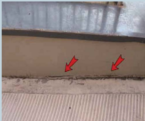
Risvolto verticale di membrana in bitume polimero (staccato), fuoriuscente di circa 1 cm dal piano di scorrimento delle acque costituita da una pavimentazione di rampa
