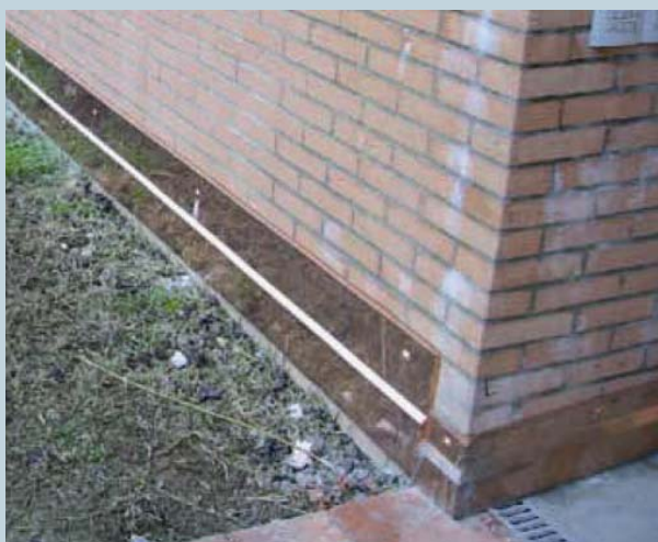
Particolare di distacco della giunzione di saldatura, per tensionamento, in un risvolto impermeabile in membrane in bitume polimero, realizzato in continuo tra superficie corrente e supporto verticale di contenimento.
