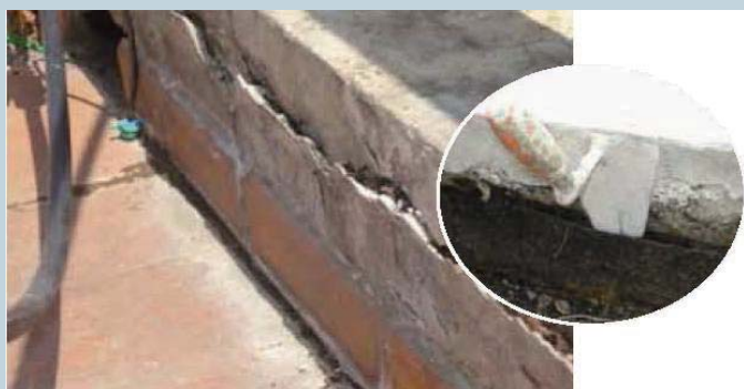
Risvolto verticale di membrana in bitume polimero, non correttamente incollato al supporto, che si è aperto staccando anche la protezione in intonaco.
