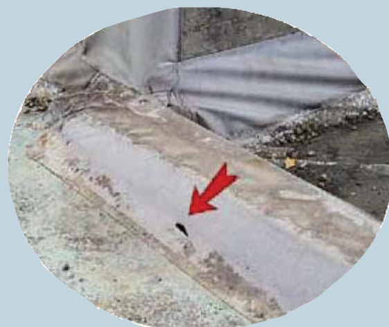
Risvolto verticale in membrana di PVC-P, prodotta per "calandratura", realizzato su una trave rovescia, senza fissaggio al piede dei risvolti e con zavorramento (già rimosso) in ghiaia. Le variazioni dimensionali dovute al naturale invecchiamento del prodotto (perdita di plastificante) hanno messo in tensione i risvolti verticali, causando persino la lacerazione, in alcuni punti.
