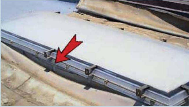
Risvolto verticale in membrana di PVC-P, prodotta per "calandratura", realizzato su un basamento di lucernario una trave rovescia, senza fissaggio al piede dei risvolti e con zavorramento (già rimosso) in ghiaia. Le variazioni dimensionali dovute al naturale invecchiamento del prodotto (perdita di plastificante) hanno messo in tensione i risvolti verticali, causandone lo "sfilamento" da sotto il telaio del lucernario.
