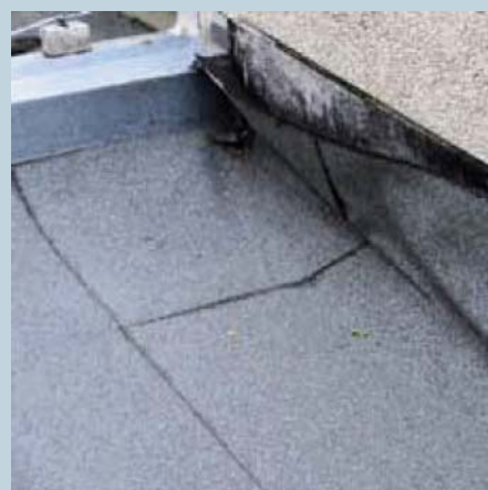
Risvolto verticale in membrana in bitume polimero, realizzato su un parapetto monolitico. La membrana è risvoltata a "ciabatta" troppo larga ed è stata incollata al supporto verticale, senza operare alcun fissaggio meccanico superiore.
