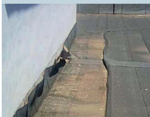
Risvolto verticale di membrana in bitume polimero, risvoltata direttamente dal piano sul verticale. La mancanza di una protezione e fissaggio meccanico sulla parte terminale, ha causato, per il calore estivo, lo scollamento della membrana dal supporto.
