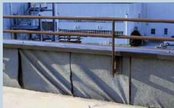
Risvolto verticale in membrana in bitume polimero, realizzato in continuo tra superficie corrente e supporto verticale di contenimento, distaccato ed ondulato. La causa di questa "patologia" sono le tensioni generate, al piede del risvolto, dalla mancanza di un adeguato strato separatore (es. film di polietilene microforato o cartonfeltro bitumato) posto sotto la pavimentazione ed anche alla mancanza di un adeguato elemento comprimibile e separatore (es. polietilene o polistirene espanso) posto, nello spessore della pavimentazione in adiacenza al risvolto verticale.
