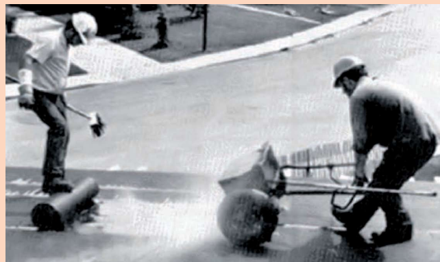
Applicazione di impermeabilizzazione in multistrato di bitume ossidato fuso e cartoni bitumati.
