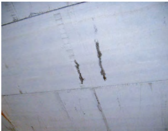
Solaio prefabbricato, alleggerito con pignatte – gocciolamenti in atto.
