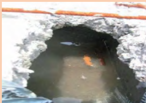
Solaio prefabbricato, alleggerito con cavità precostituite – presenza di acqua all'interno delle cavità.
