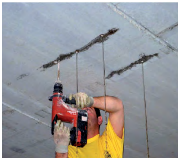
Solaio prefabbricato, alleggerito con pignatte – foratura all'intradosso, con svuotamento dell'acqua contenuta nelle pignatte.
