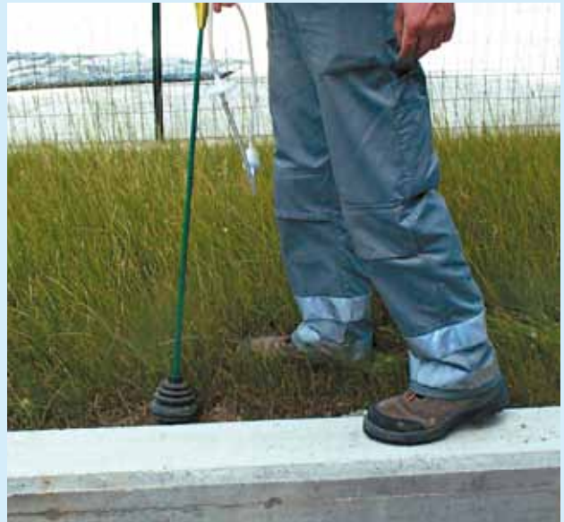
■ Rilevamento fughe di gas da difettosità dello strato impermeabile.
