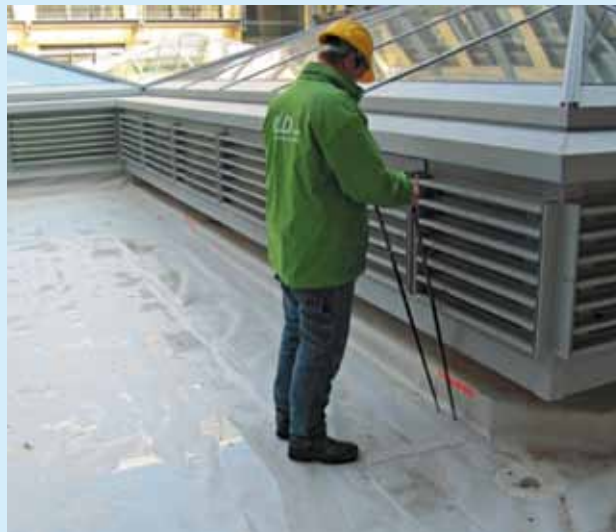
■ Collaudo dello strato impermeabile con la ricerca dei punti di "messa a terra".
