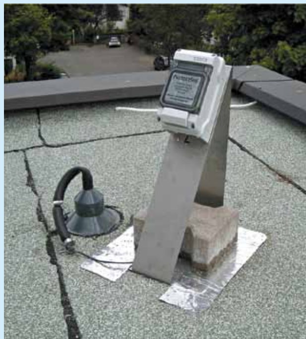
■ Sistema di rilevamento "PROTECTSYS® B" scatola di connessione, posta in copertura, connettibile, in fase di ricerca, al "generatore d'impulsi".
