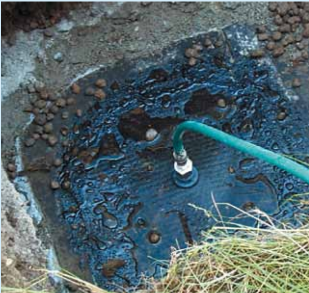
■ Valvola d'immissione gas, collegata all'intradosso dello strato impermeabile.
