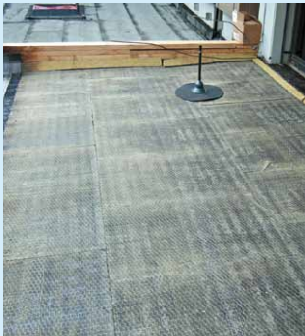
■ Sistema di rilevamento "PROTECTSYS® B" con inserimento di retina in acciaio inox, conduttrice di corrente elettrica, direttamente all'intradosso dello strato impermeabile.
