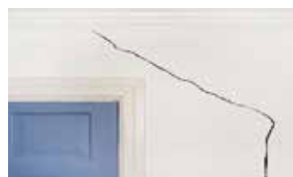
● CREPE E FESSURE MURI
